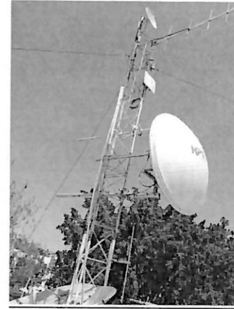
Se emplea el enlace digital Cambium con antena Radomo, para conectividad de las cámaras de video vigilancia para monitoreo del transmisor y equipos de transmisión.
